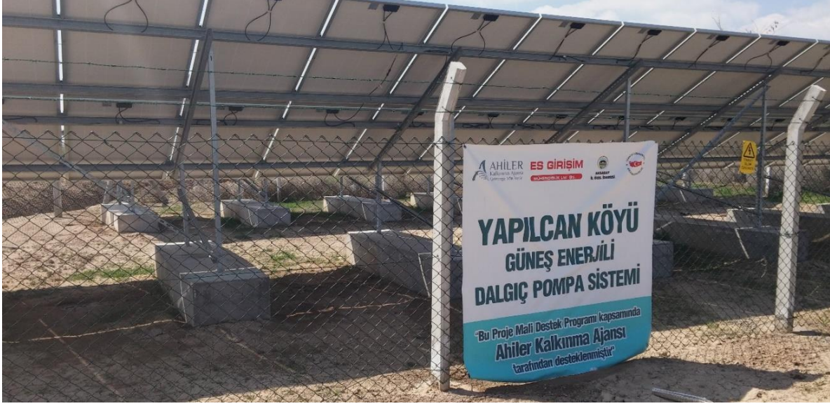
Resim 12 Güneş Enerjili Dalgıç Pompa Sistemi Uygulama Projesi, Aksaray İl Özel İdaresi
