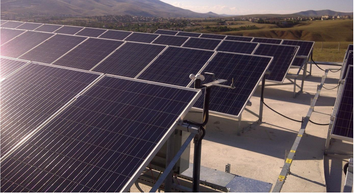
Resim 14 Pv-Fotovoltaik Elektrik Üretim Tesisi, Oralsan Mak. Tak. San. ve Tic. A. Ş., Kırşehir
