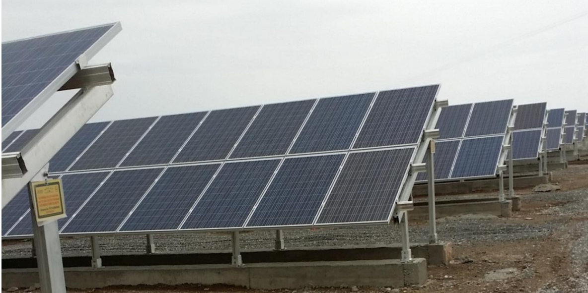
Resim 13 210 Kwh Güneş Paneli Sistemi, Metaş Madencilik End. Tic. Ltd. Şti., Nevşehir
